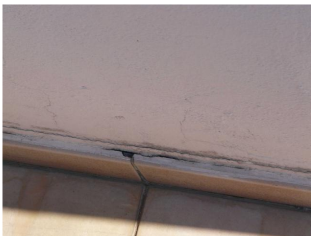
Revne ved sokkel
